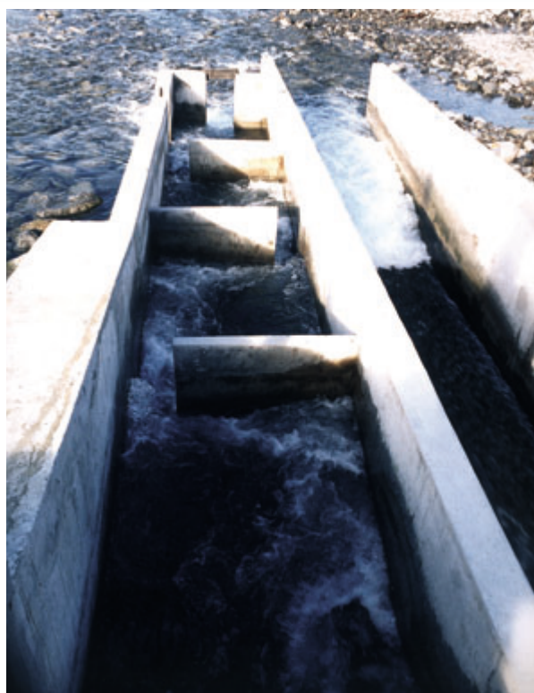
Passé à poissons et délivrance du débit réservé.
