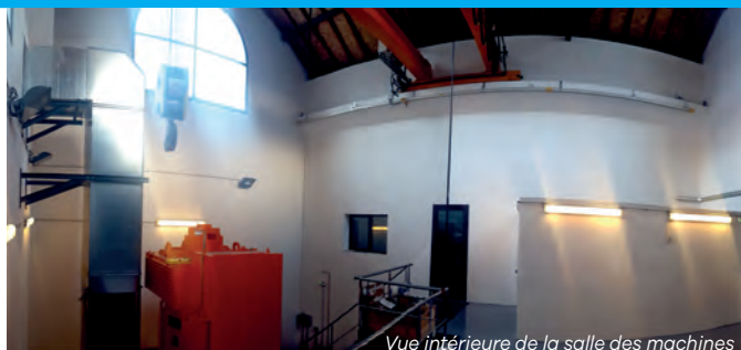
Vue intérieure de la salle des machines
